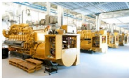
Photo : moteurs de la centrale électrique
